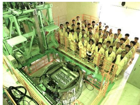
写真5 完成した STACY 更新炉 (炉心タンク周辺)
